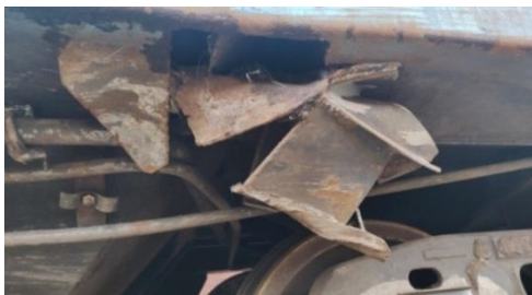
Рис. 9. Пошкодження кронштейна для підйому кузова вагона
