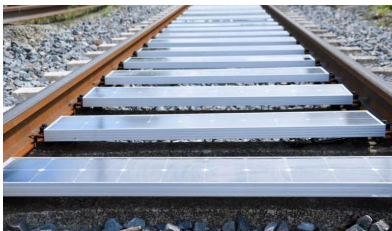
Рис. 2. Сонячні панелі, встановлені на шпалах німецької залізниці
