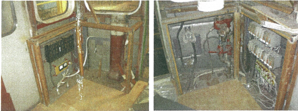
Рис. 6, 7. Оборудования кабины машиниста размещено в торцевых и боковых шкафах салона вагона
