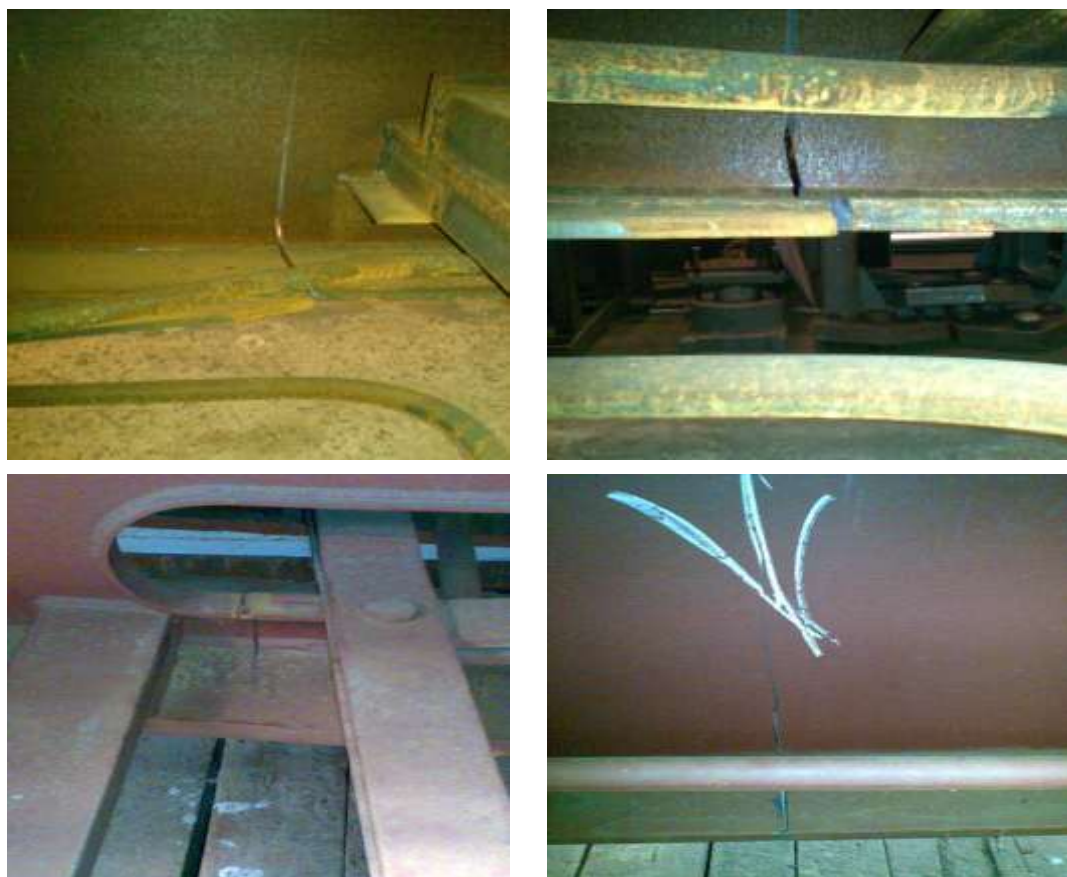
Рис. 5. Загальний вид руйнувань у хребтових балках на довгобазному вагоні-платформі для перевезення 40-ка футових контейнерів
